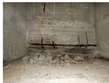
剥離・鉄筋露出
