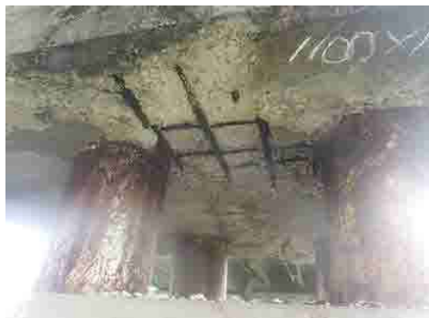
剥離・鉄筋露出 (着手前)
