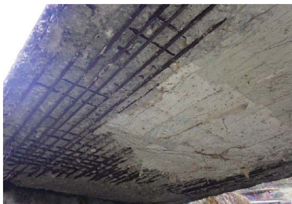
剥離・鉄筋露出
