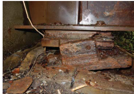
支承の回転破損 (右岸上流)
