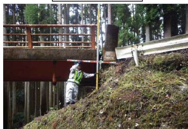
背面崩壊による沈下・移動傾斜
