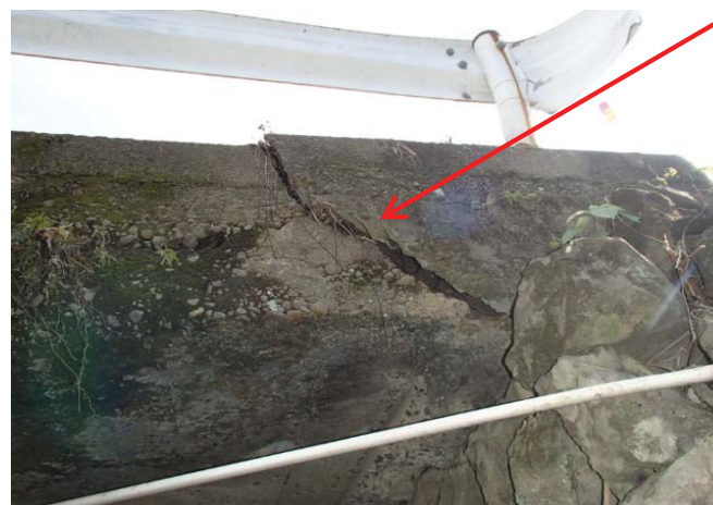
床版のクラック
