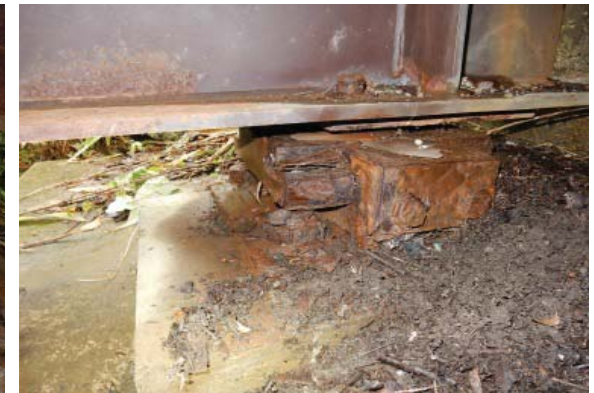
支承の破損 (右岸下流)
