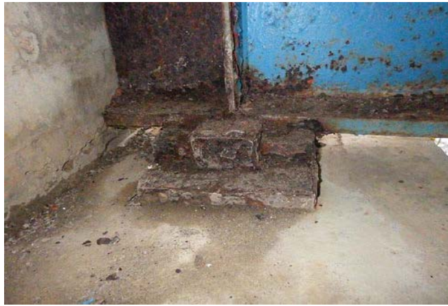
支承機能障害
