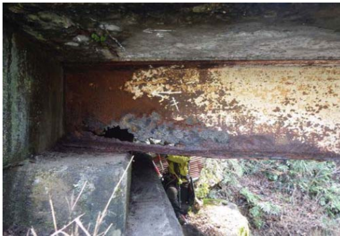
主桁の腐食、変形
