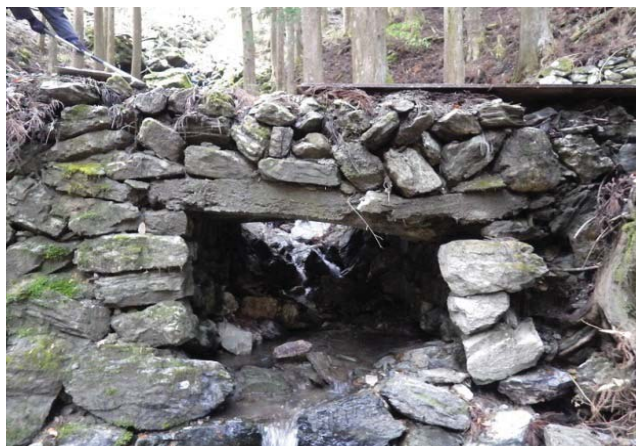
石積みの開き・クラック
