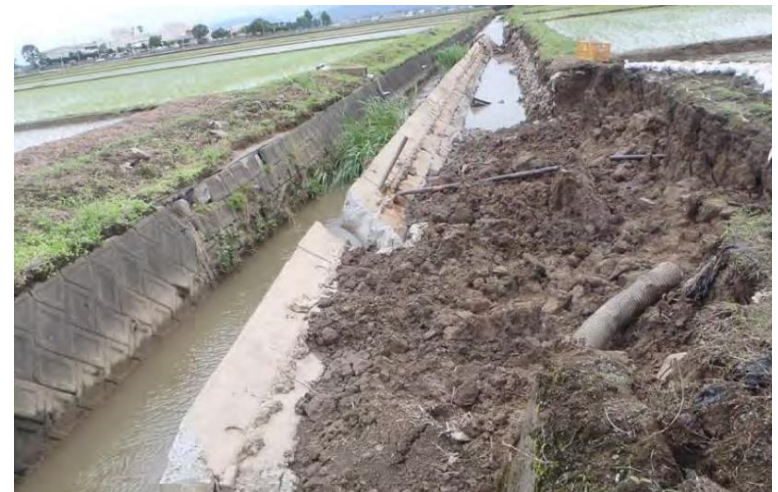
排水路の被災
