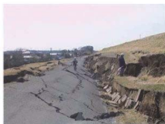
利根川下流(右) 71k 付近 (千葉県印旛郡栄町) ※堤体も液状化している可能性
