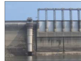
【選択取水設備の改造・運用】
