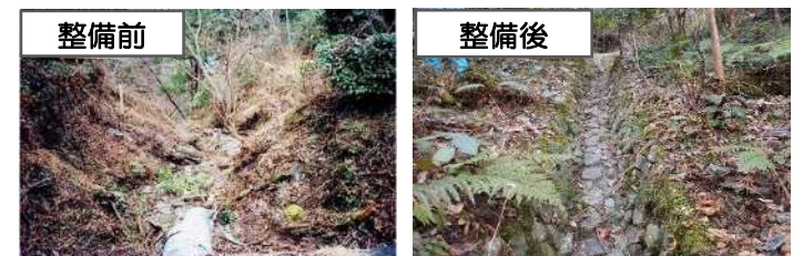
洪水流出で斜面が侵食
