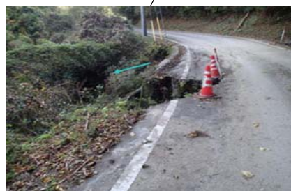
ダム湖周辺の県道崩壊
