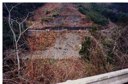
ダム湖周辺の法面崩壊
