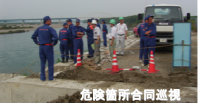
危険箇所合同巡視
