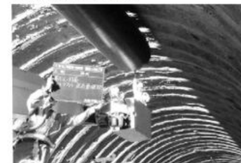
送風機から新鮮な空気がトンネルに吹き込まれます。
