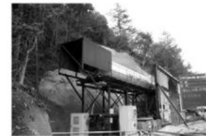
大きな屋外の送風機。トンネルの奥へ空気を送ります。
