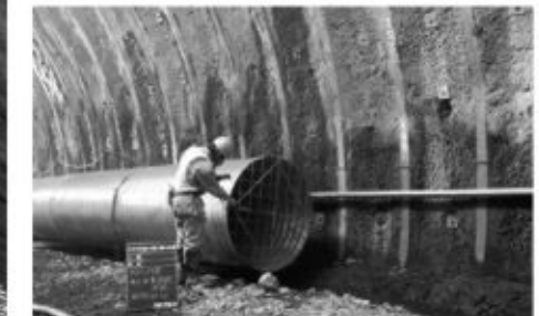
集塵機パイプで集塵機へ汚れた空気を送ります。
