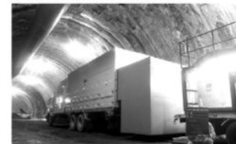
作業場所の近くに設置された集塵機。
