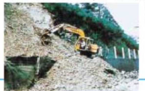
日和佐町大戸の土砂崩れ現場
