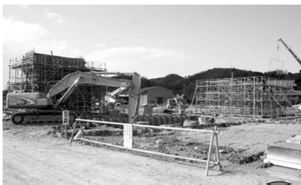
これは、橋台の基礎工事の様子じゃよ。左奥が下りの橋台で、右が上りの橋台じゃ！
