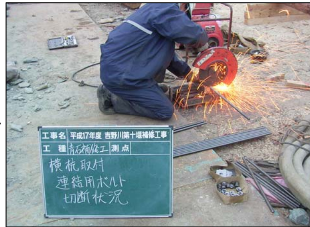
6.杭木・横杭連結用ボルト切断状況
