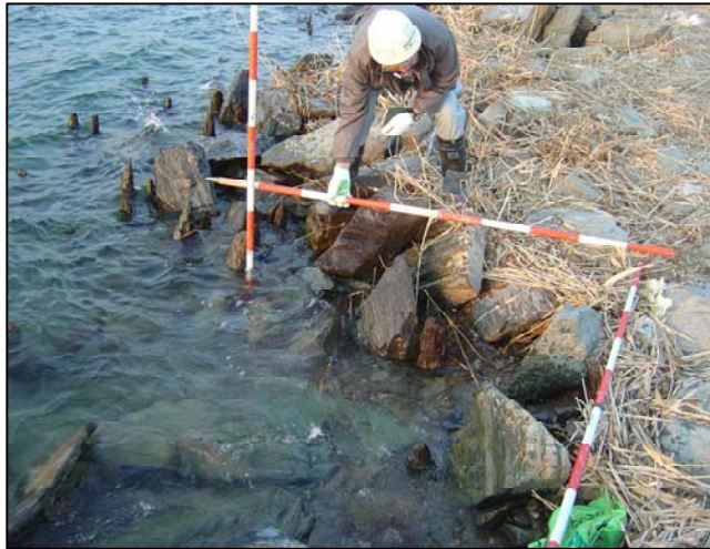
変状箇所 B
