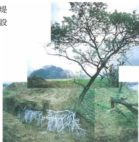
写真 3. 1. 2 堤防法尻付近に延伸する根系の状況 1)
