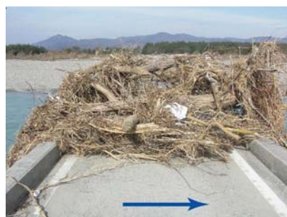
潜水橋に引っ掛かる流木の状況 (地点：31. 6k, 学島橋)
