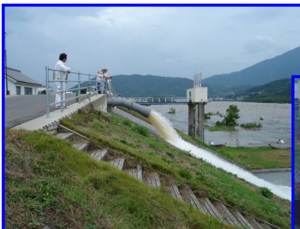
【城ノ谷排水機場稼動状況（8月1日）】
