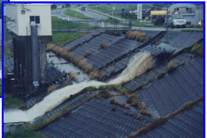
【前川救急（内水）排水機場稼動状況（8月1日）】
