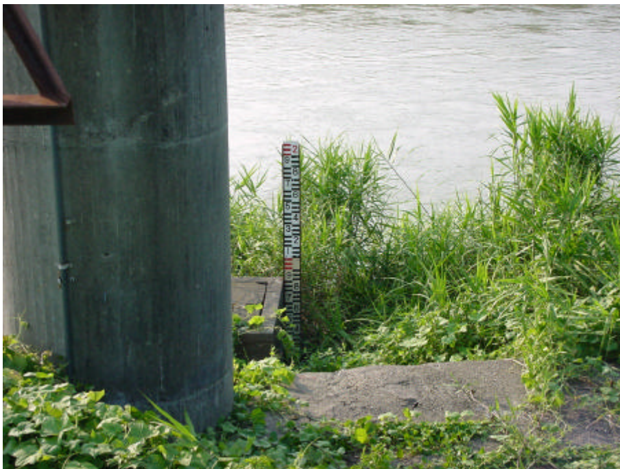
普通水位観測所水位標（旧吉野川観測所）
