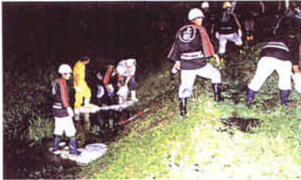
■平成11年7月の洪水による水防活動 堤防の漏水で月の輪工対策を実施している状況 (吉野川左岸/河口より17.4km付近)
