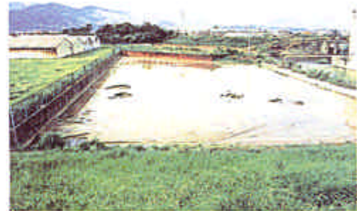
■平成2年9月の台風19号による「ボイリング」状況 (上坂町六條/河口より16.6km付近)
