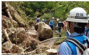
崩落箇所の測定状況(菊池市)
