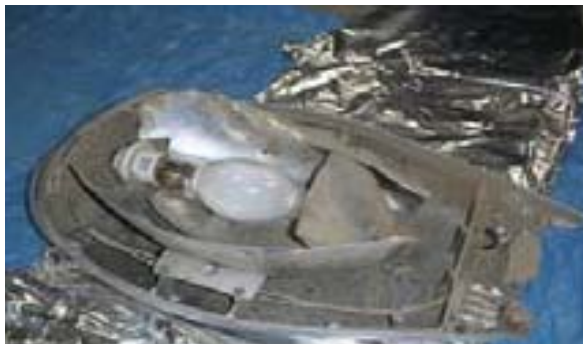
道路照明灯（灯具）
