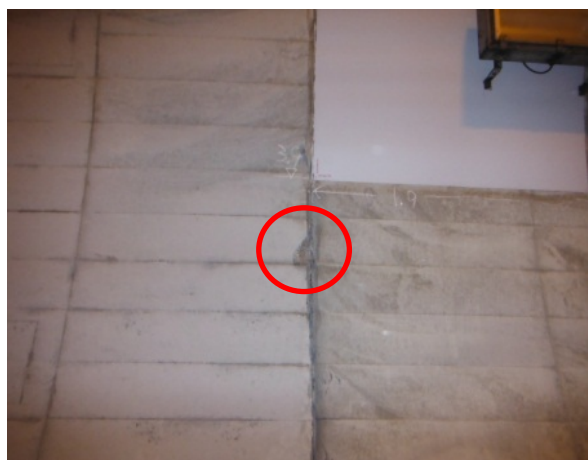
コンクリート片が剥落した壁面
