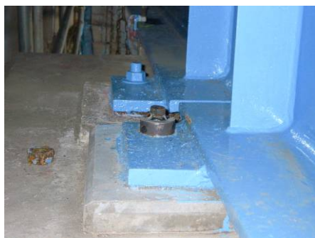
沓座モルタル補修の例
