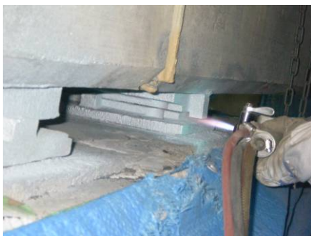
支承防錆の例
