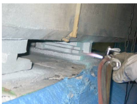
支承防錆の例
