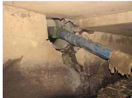
管渠部の損傷
