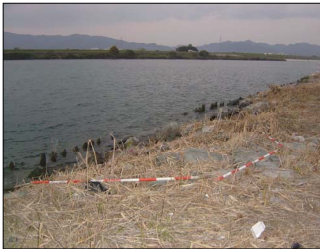
変状箇所 M
