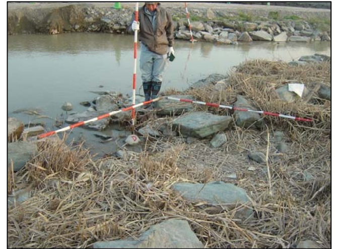
変状箇所 D
