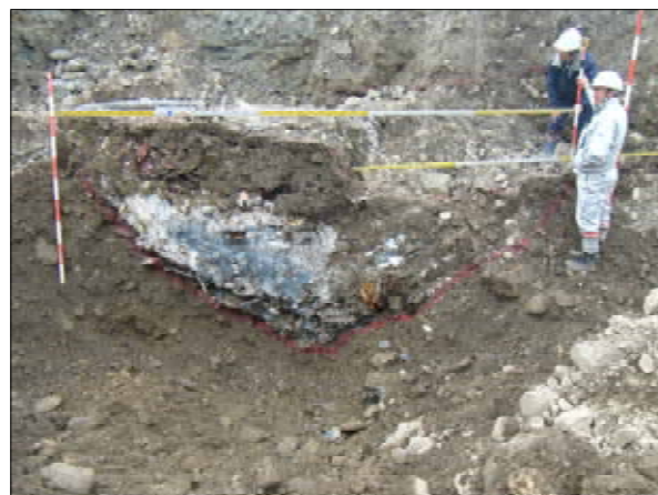
【混入土層2(変状箇所)】
