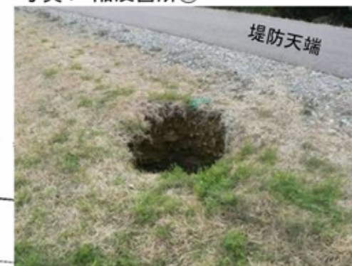
写真1 陥没箇所①
