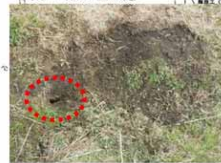
写真2 陥没箇所②
