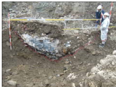
【混入土層2(変状箇所)】
