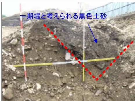
【混入土層1(陥没箇所)】
