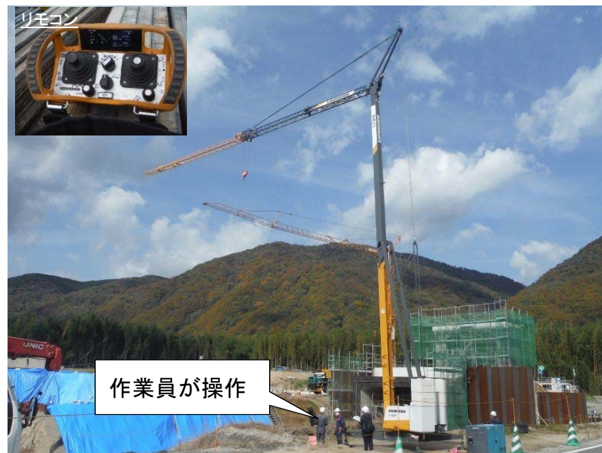
操作状況 (古川樋門)
