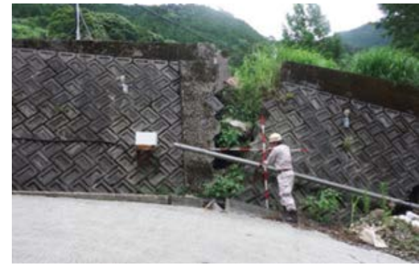
被災箇所の点検
