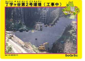
ちよじがたにえんじ 丁字ヶ谷第2号堰堤(工事中バージョン) (愛媛県東温市則之内)
