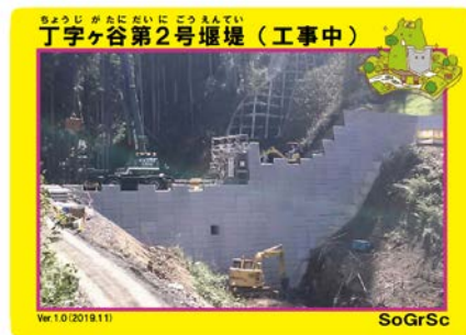
ちょうじがたにだいにえんてい 丁字ヶ谷第2号堰堤(工事中バージョン) (愛媛県東温市則之内)
