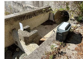
写真-3 Wi-Fiとバッテリーの設置状況
