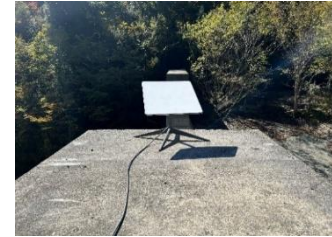
写真-2 衛星アンテナの設置状況
