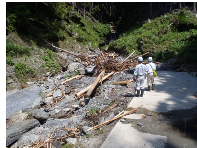
写真-4 砂防堰堤上流の河道に堆積した土砂・流木の状況
