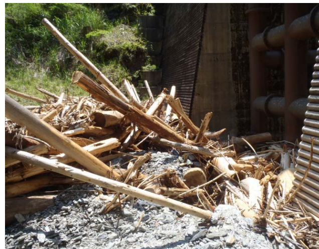
写真-3 砂防堰堤上流の鋼製スリット付近に堆積した土砂・流木の状況
