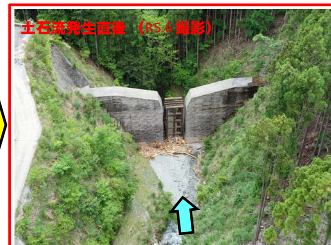
写真-2 出水後の砂防堰堤(上流側)の状況
