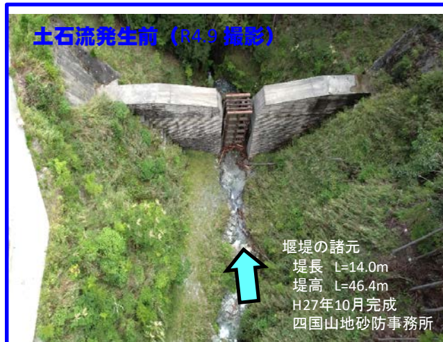
写真-1 出水前の砂防堰堤(上流側)の状況
