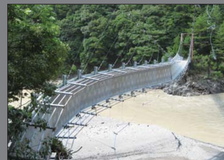
⑥段波による上流側の平鍋吊橋破壊
