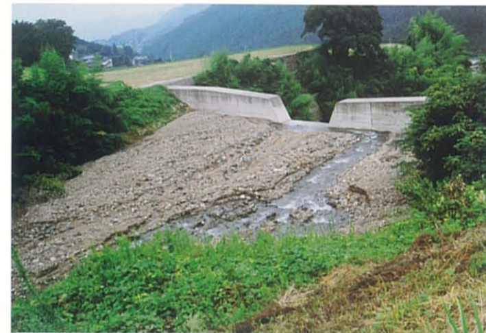
① 土石流を捕捉し満砂した白猪谷堰堤（白猪谷）
