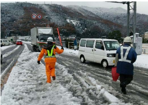
職員が通行止めを実施
