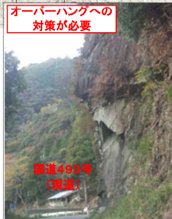
写真 防災上危険な箇所
