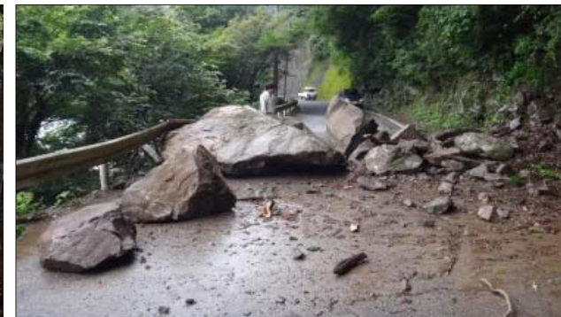
写真② 国道493号落石状況
