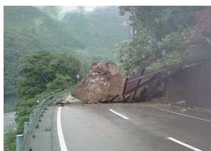
H22.8.16 岩盤崩壊の状況
