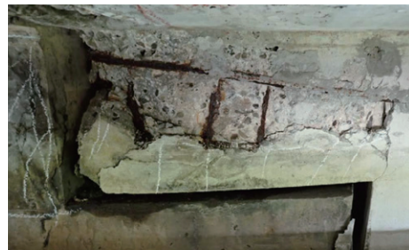
主桁の剥離・鉄筋露出（香川県東かがわ市 大川橋）
