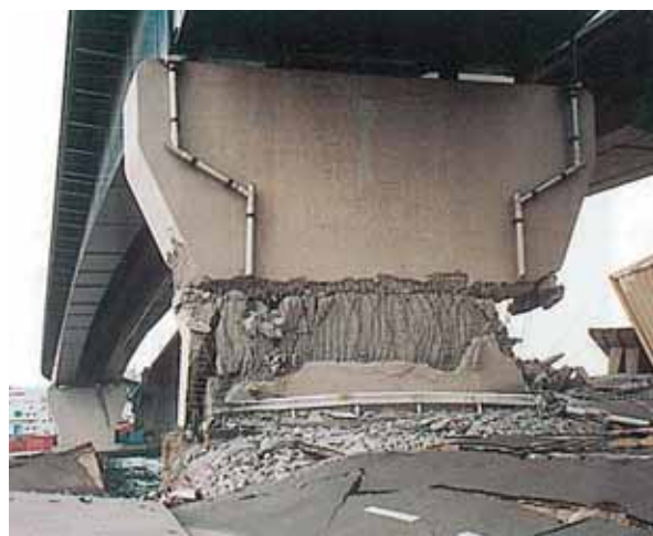
兵庫県南部地震により損傷した橋脚
