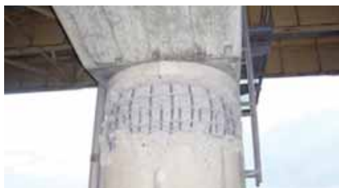
新潟県中越地震により損傷した橋脚
