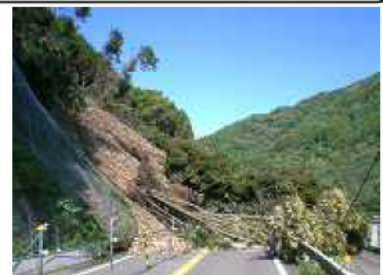
平成19年7月 山腹崩壊
