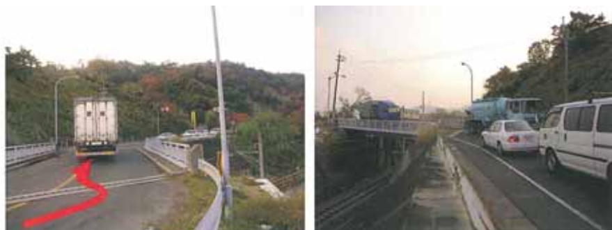
写真 - 10 国際コンテナ通行支障区間（線形不良）の状況
