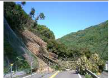
平成19年7月 山腹崩壊
