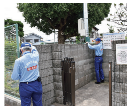
被災状況調査 (建築)
