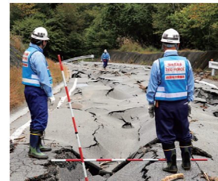
被災状況調査 (道路)
