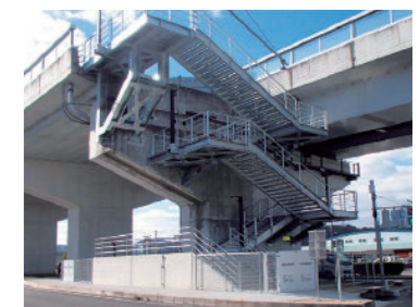
宇和島道路に設けられた緊急避難階段
