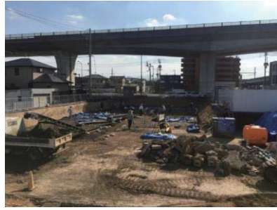
▲駅前広場整備箇所から、埋蔵文化財が出土したため、発掘調査を行う。
