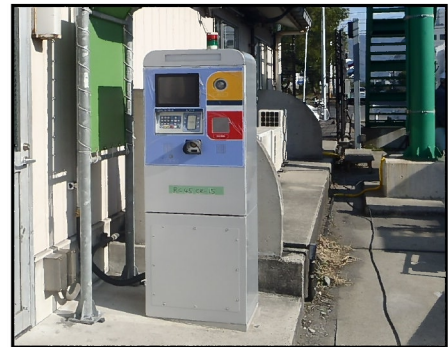
荷物搬出入票の受付窓口前に設置された 出入管理情報システムの筐体型リーダー
