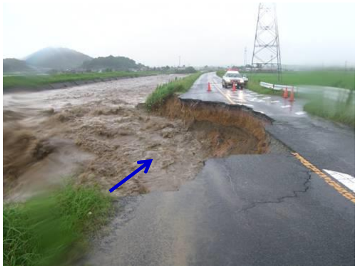
堰の流失時に侵食された堤防
