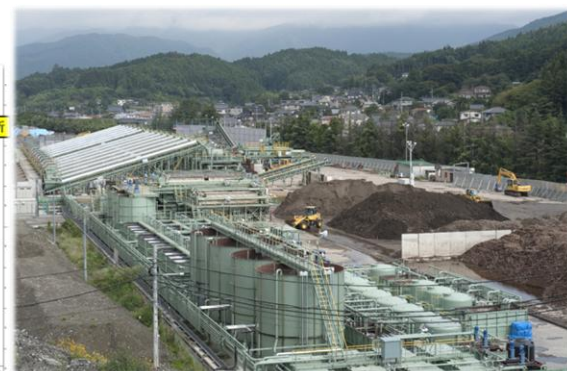
災害廃棄物セメント資源化設備
