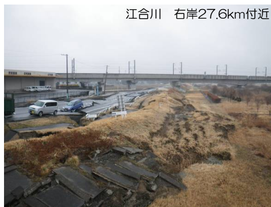
堤防の沈下、護岸の損傷が発生
