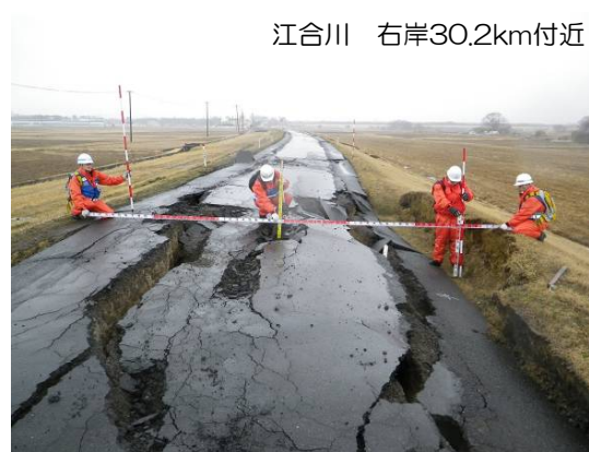
堤防にクラックが発生
