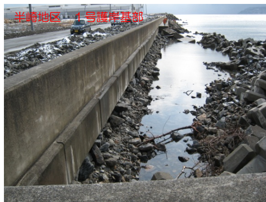
半崎地区 1号護岸基部 被覆ブロックの散乱、基礎材の崩れが発生
