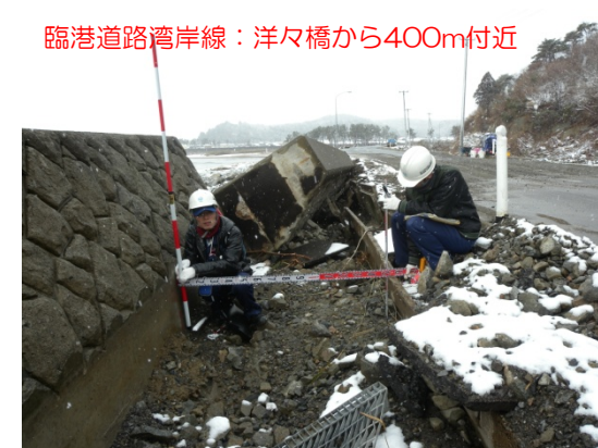
臨港道路湾岸線：洋々橋から400m付近 護岸波返し部の倒壊、歩道の損壊
