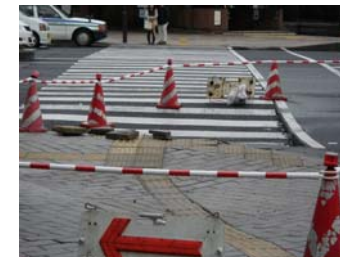
路面陥没状況
