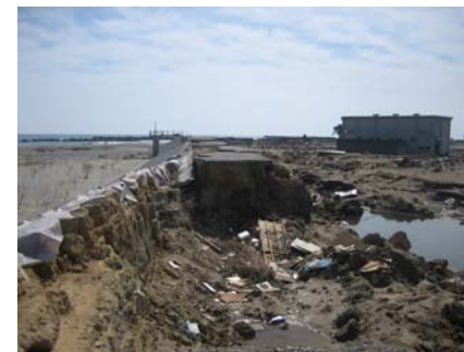
〔阿武隈川堤防の被災状況〕
