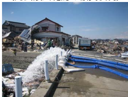
〔排水ポンプ車の稼働状況〕
