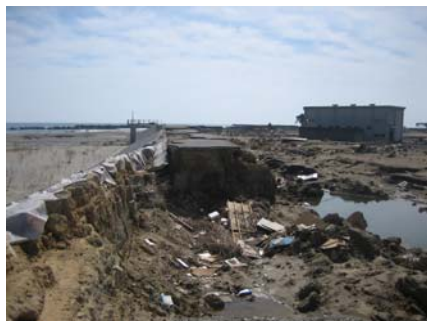
〔阿武隈川堤防の被災状況〕
