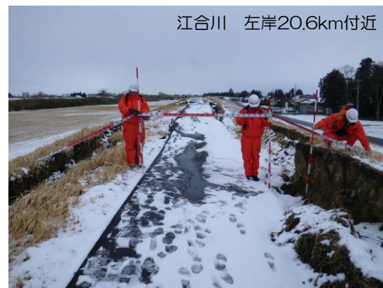
雪の中での調査（堤防の沈下）
