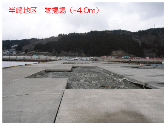
コンクリート版の沈下・剥離、流出が発生
