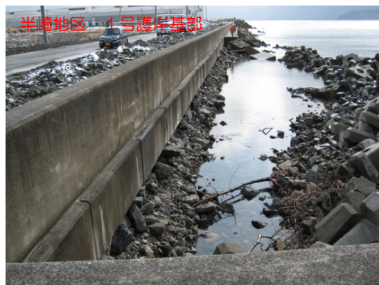
被覆ブロックの散乱、基礎材の崩れが発生
