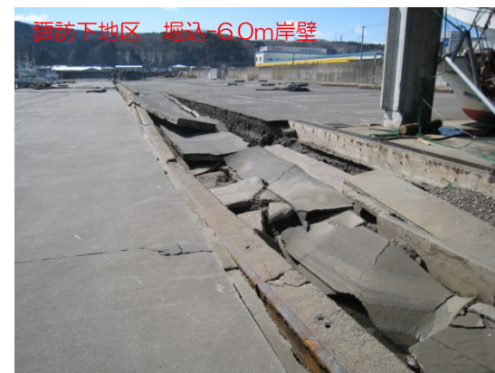
棧橋構造の渡橋版の損壊、飛散状況
