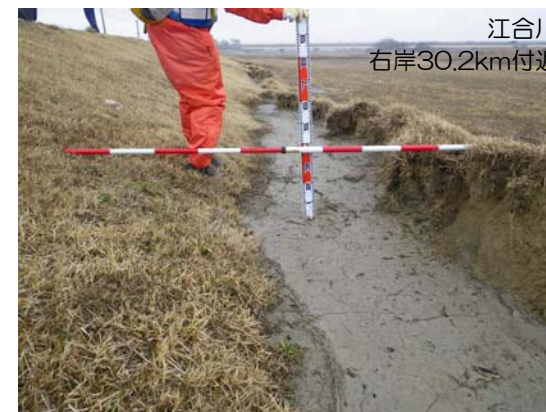
液状化現象による噴砂の状況
