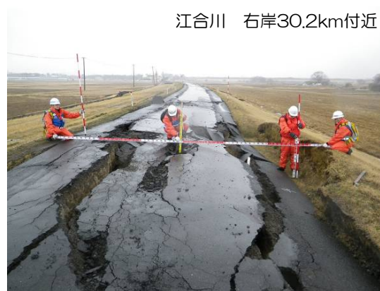
堤防にクラックが発生
