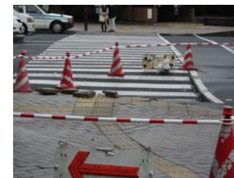
路面陥没状況
