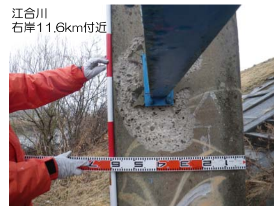
樋門門柱のコンクリートのはく離
