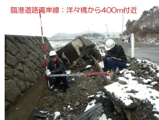
護岸波返し部の倒壊、歩道の損壊
