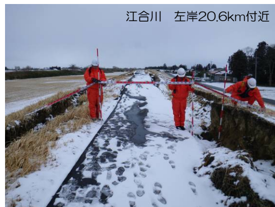
雪の中での調査（堤防の沈下）
