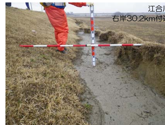
液状化現象による噴砂の状況
