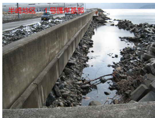
被覆ブロックの散乱、基礎材の崩れが発生
