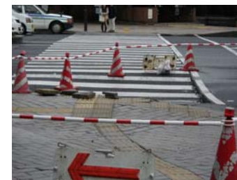
路面陥没状況
