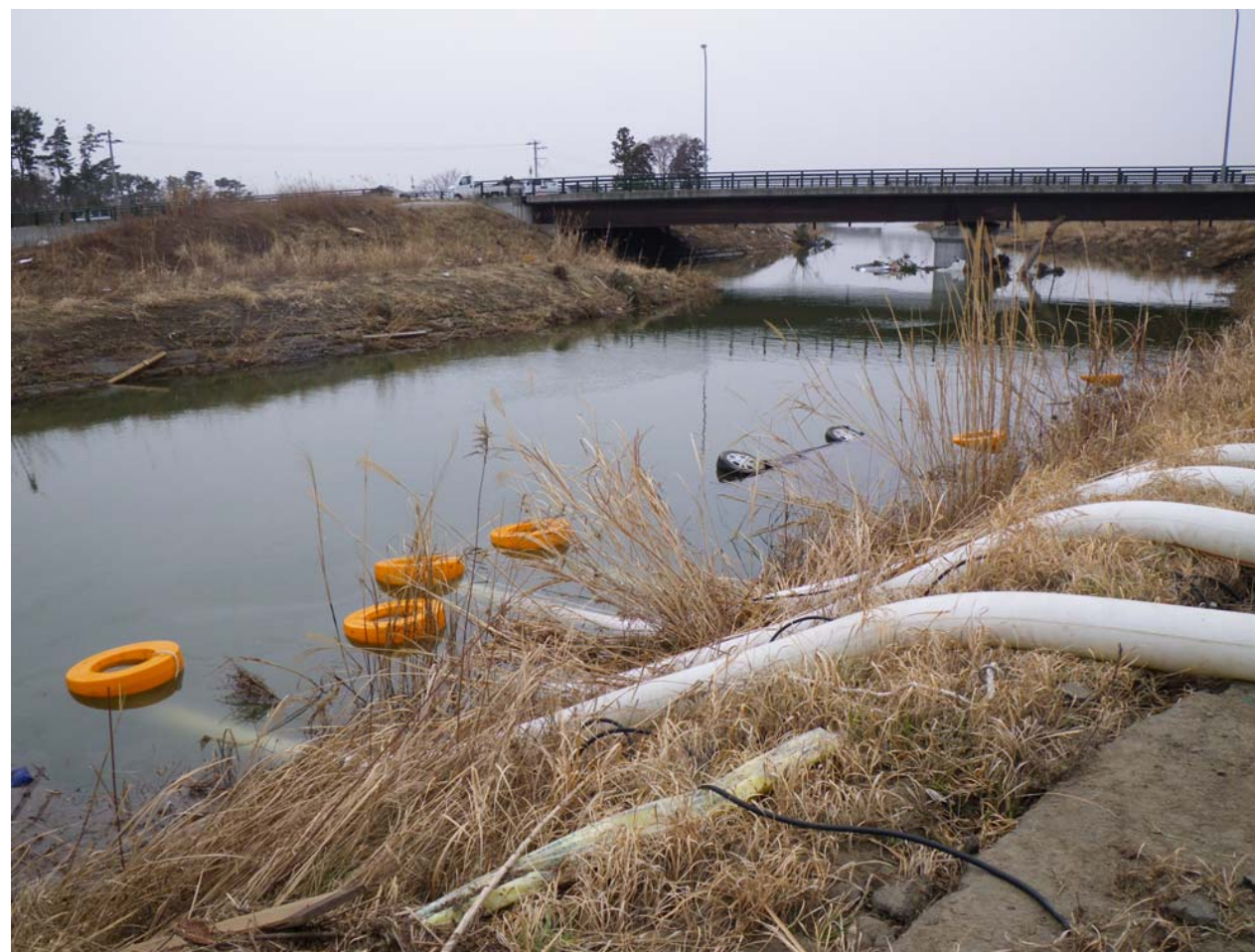
災害対策用稼働写真 3月20日 派遣箇所 ② 排水ポンプ車(18-4892)
